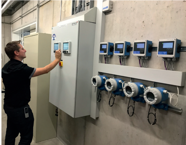
Monitoren van efficiëntie van ketels, koelinstallaties en warmtewisselaars
