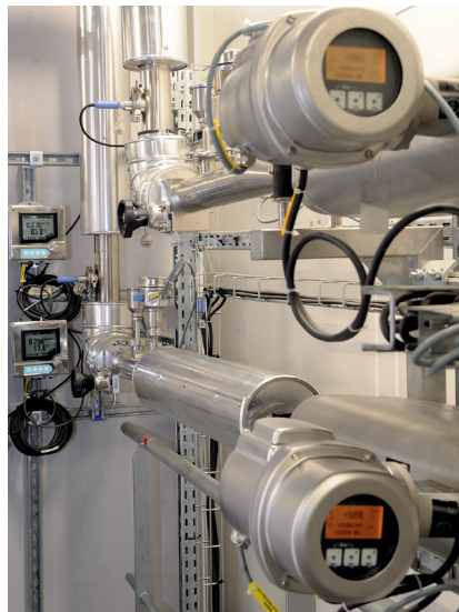
Flowmeting in WFI-loop met Promass P.
